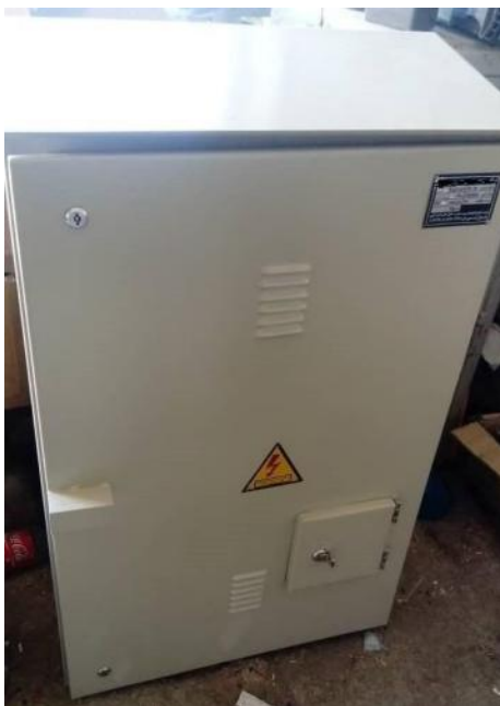
شکل (1): تابلو اختصاصی دیماندی
